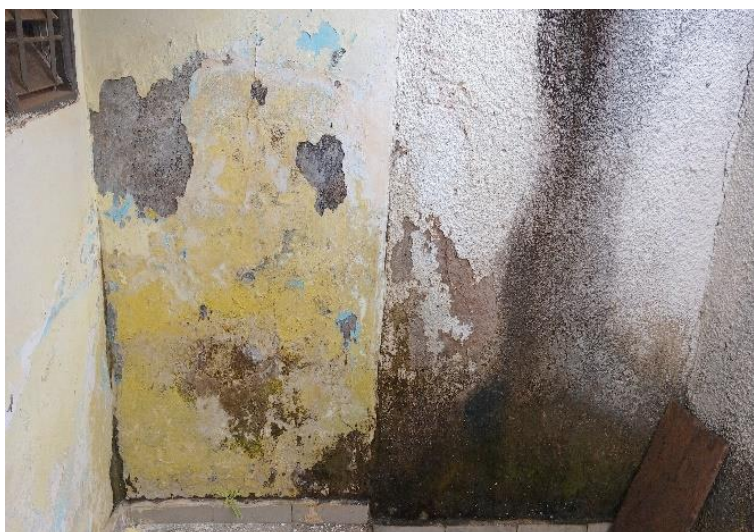
Photo 3 : Chute du crépi et présence de moisissure sur le mur à Gbokora
